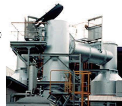
キューボラ頂部の排ガス処理装置の外表
